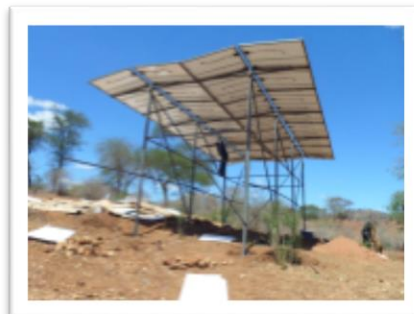
Paneles solares ofertados
